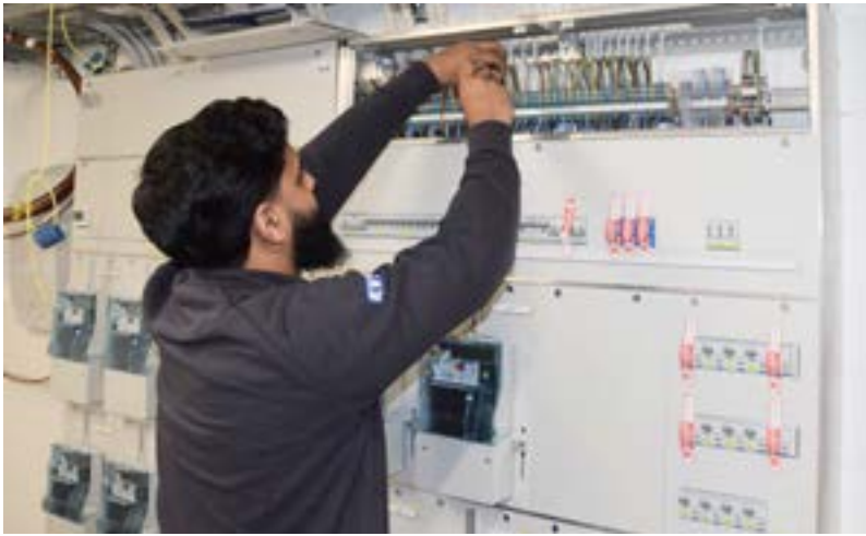
Die «Zentrale» der Überbauung Breite. Thanujan Thambiah legt Hand an.
